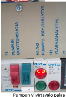
Pumpun ylivirtavalo palaa
